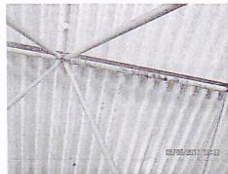
Jumta nesošās metāla konstrukcijas daļēji korodējušas, nav veikta to pretuguns apstrāde
