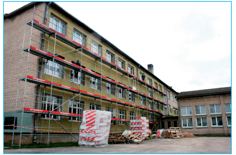
Siltina Balvu 2.pamatskolas fasādi. Projektu realizējot trīs novada izglītības iestādes kļūs siltākas, iegūs ievērojamus siltumenerģijas ietaupījumus un glātu ārējo izskatu.
