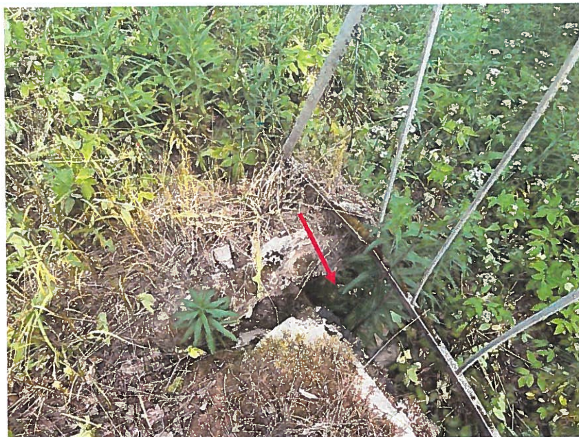
20.att. Izskalojums uzbērumā. Skats pie krasta balsta Nr.1 augšteces pusē.
