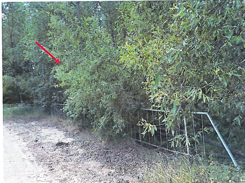
15.att. Veģetācija un apaugums uz konstrukcijām pie tilta.
