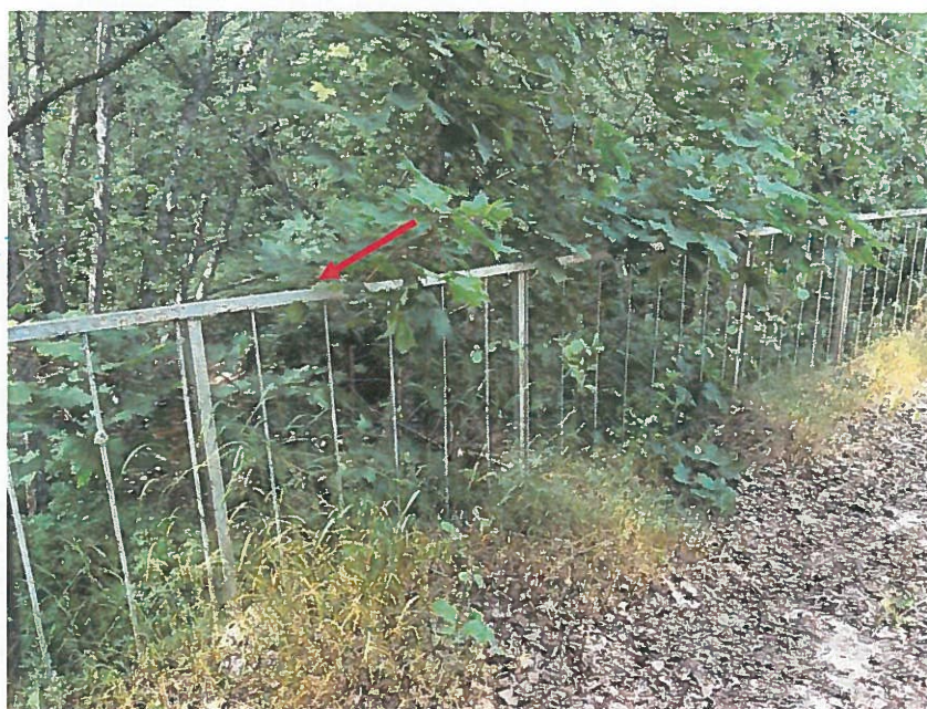
6.att. Korodē tilta margas, vietām mehāniski deformētas. Skats lejteces pusē.
