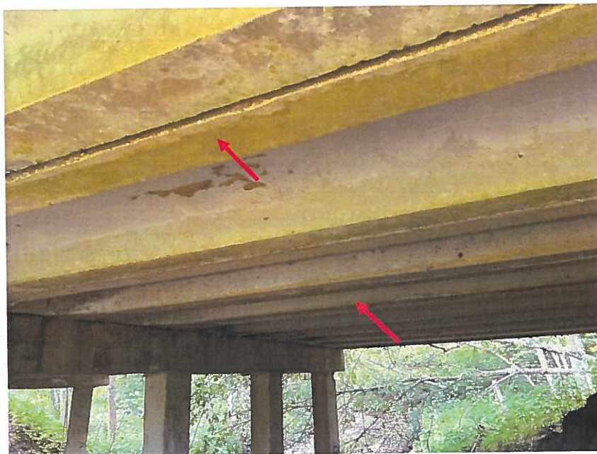
7.att. Plaisas, nodrupis laiduma konstrukcijas betons, atsegts korodē darba stieņojums, notiek ūdens caursūkšanās. Skats uz 1.laidumu no apakšas.
