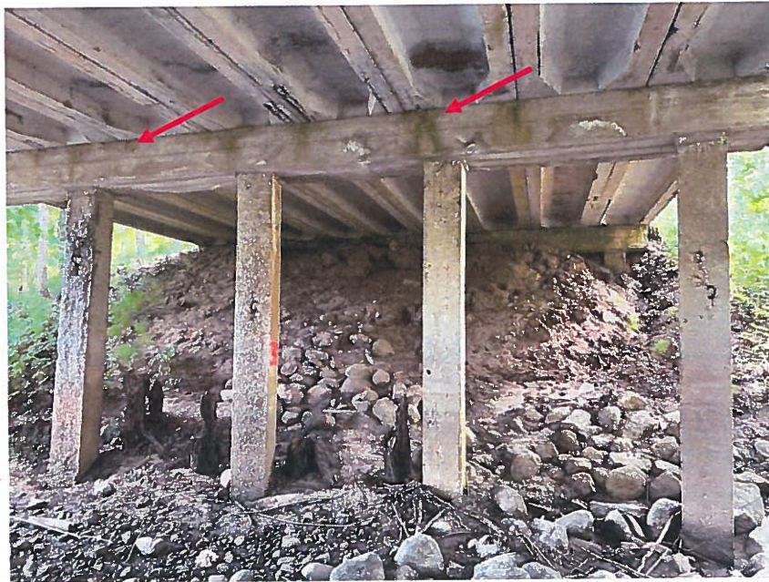
11.att. Cauri deformācijas šuve cauri tek ūdens, drūp betons, korodē stiegrojums. Skats uz upes balstu Nr.3.
