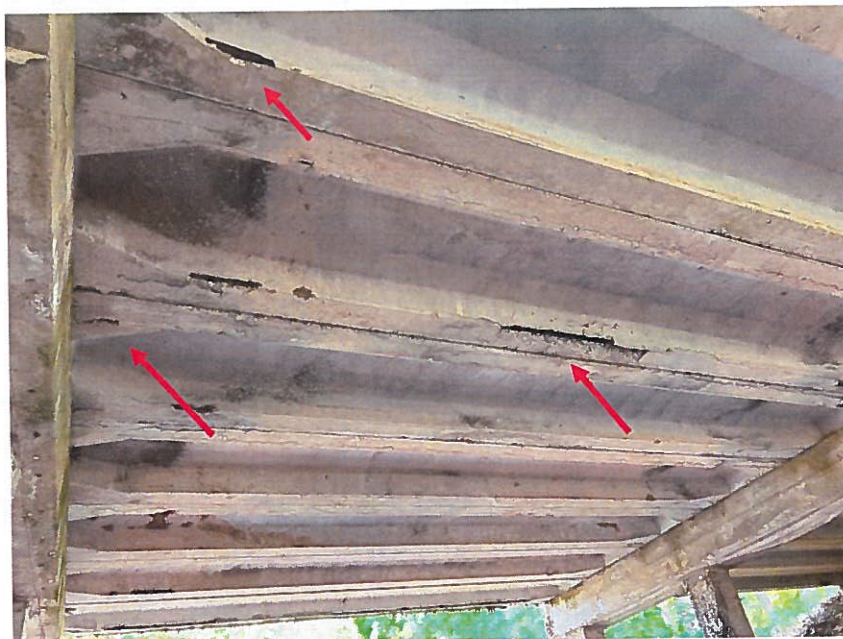
8.att. Plaisas, nodrupis laiduma konstrukcijas betons, atsegts korodē darba stieņojums, notiek ūdens caursūkšanās. Skats uz 2.laidumu no apakšas.
