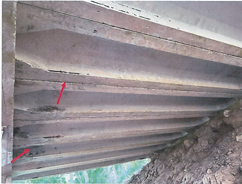
9.att. Plaisas, nodrupis laiduma konstrukcijas betons, atsegs korodē darba stiegrojums, notiek ūdens caursūkšanās. Skats uz 3.laidumu no apakšas.
