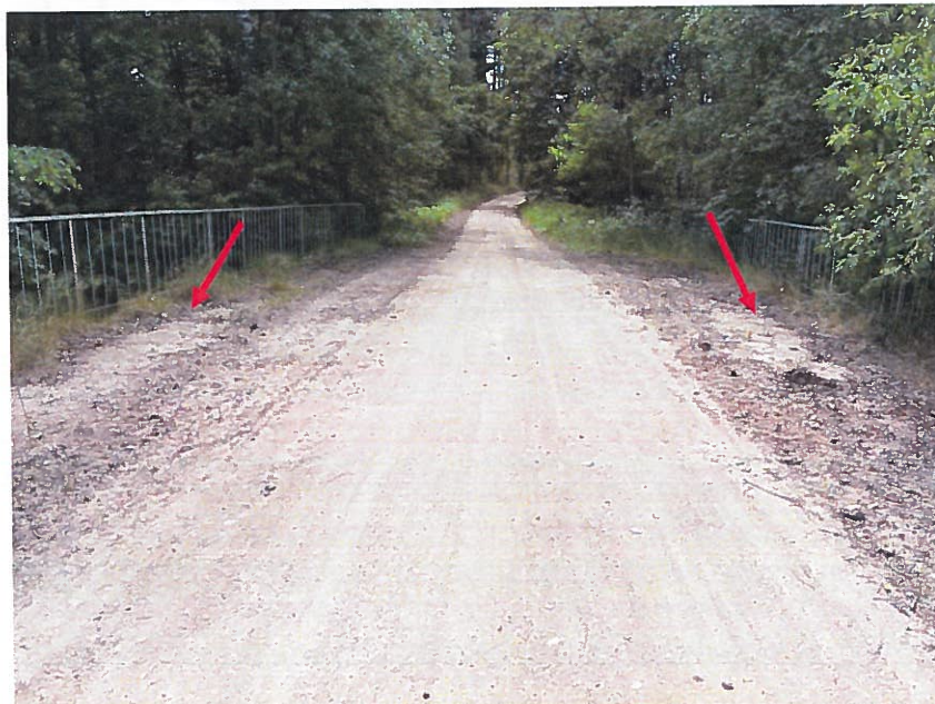
3.att. Apageumi uz tilta brauktuves malām, vietā drūp brauktuves betons. Skats uz tilta brauktuvi.
