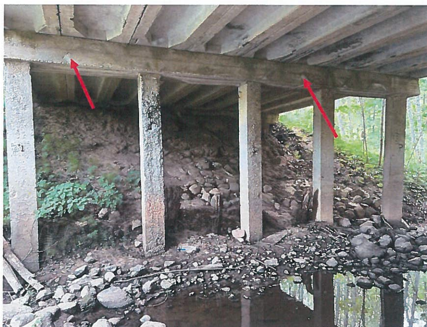
5.att. Ūdens tek cauri deformācijas šuvei. Skats uz upes balstu Nr.2.
