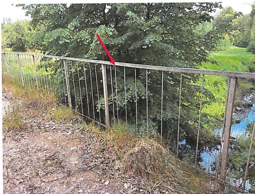
4.att. Korodē tilta margas, vietām mehāniski deformētas. Skats augšteces pusē.
