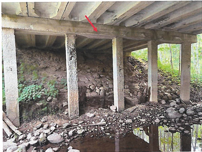
12.att. Cauri deformācijas šuve cauri tek ūdens, drūp betons, korodē stiegrojums. Skats uz upes balstu Nr.3.
