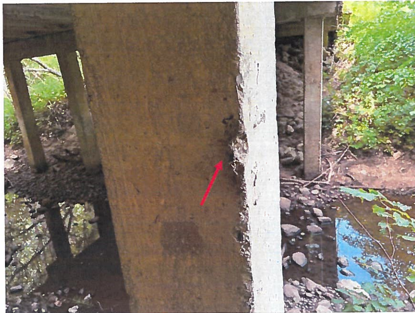
19.att. Karbonizācijas dziļums balsta konstrukcijai – 5mm. Skats uz upes balstu Nr.2 lejteces pusē.
