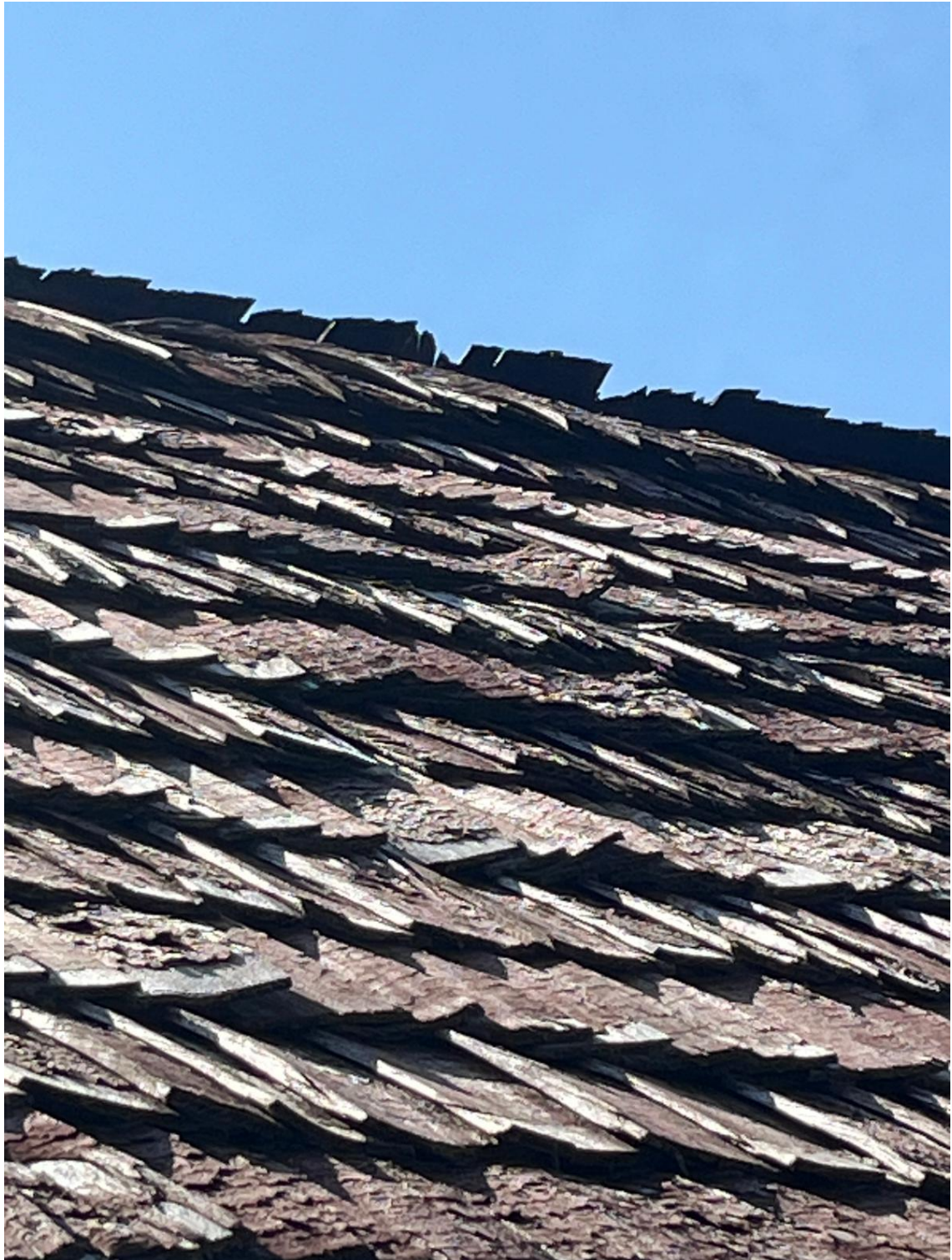
Jumta kore ar daļēji zudušiem pārkares šindeljiem. Skats no Ziemeļu puses
